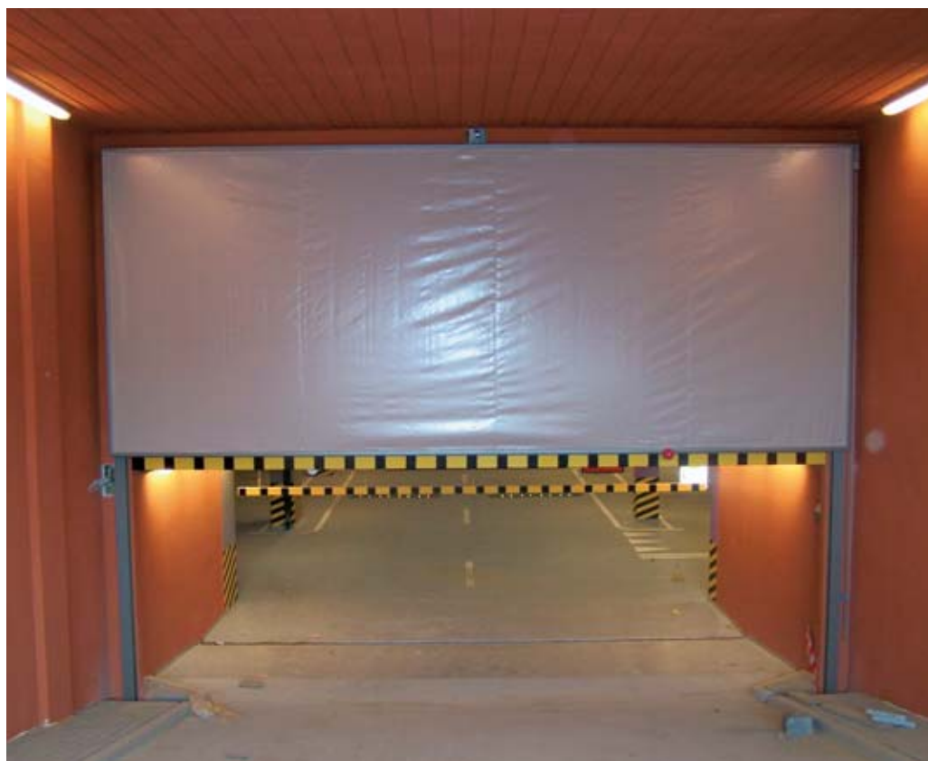
Brama opuszczana stalowa przeciwpożarowa zamontowana w Galerii Handlowej Millenium Hall w Rzeszowie – dystrybutor firma SL Sp. z o.o. / Lowered fireproof gate made of steel, installed in Galeria Handlowa Milenium Hall in Rzeszów, provider SL Sp. z o.o.
